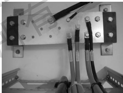
图 1-11 机房接地铜排
