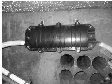
图 1-4 人孔内光缆接头盒
