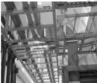
图 1-10 机房上走线示例
